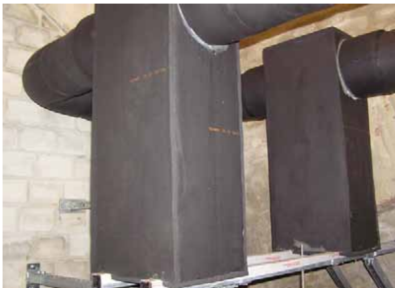
2 Grander Geräte im Stadtwassersystem
